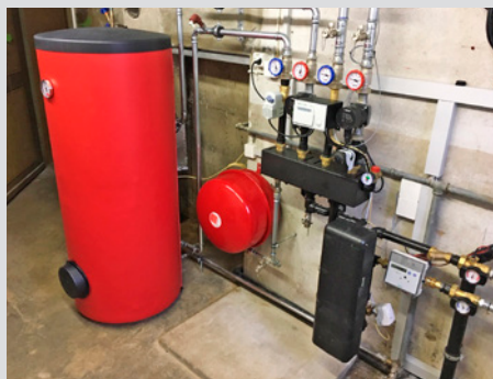
Die Wärmeübergabestation (rechts unten im Bild) benötigt nur sehr wenig Platz.
