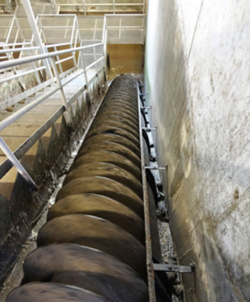
Schneckenpumpen heben das Abwasser aus der tief liegenden Kanalisation soweit hoch, dass es die Kläranlage von selber durchfliessen kann.
