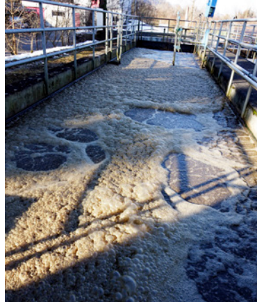
Belüftungsbecken: Kleinlebewesen, va. Bakterien, bauen die organischen Stoffe ab.
